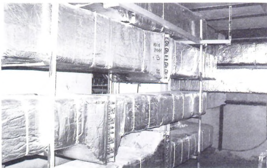
Nowe ciągi wentylacyjne Bloku Operacyjnego
